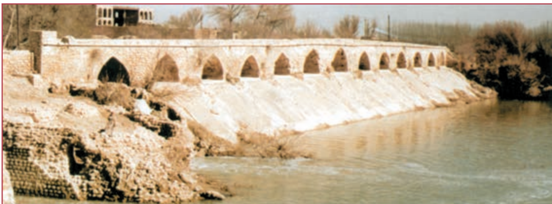
بند امیر در فارس. این بند (سد) در دوره آل بویه (عضدالدوله) ساخته شده است.
