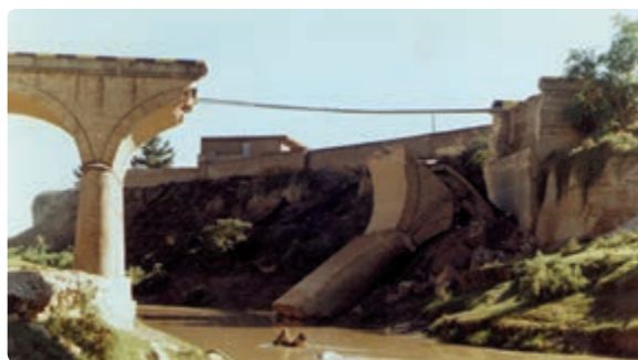
شکل ۱۵-۶- تخریب یک پل ارتباطی بر اثر سیل
